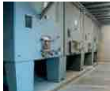
MAS JANEIL - CUVES BÉTON
